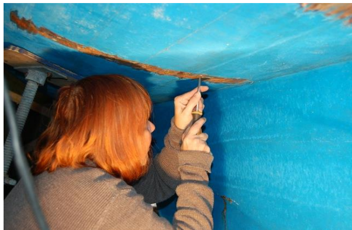
Monica jobbar med att få bort alla sönderärgade kopparskruvar. Några var i rostfritt som tur var.
